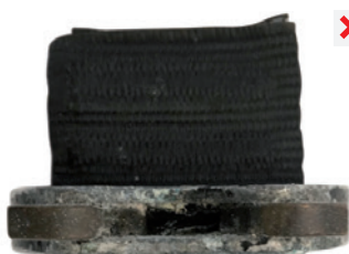
koroze spony způsobená stavebním materiálem
