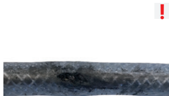
narušená krytka – servis
